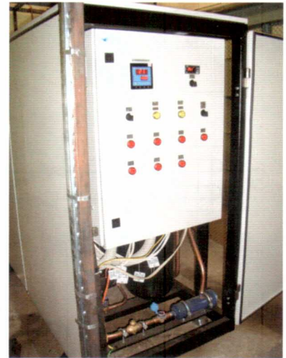
Рис. 5. Электрический щит управления установкой
